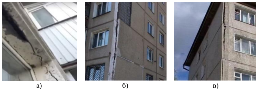
Рис. 2 - Повреждения зданий серии 335, г. Иркутск
