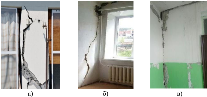
Рис. 4 - Повреждения зданий при землетрясении на Южном Урале (г. Катав-Ивановск) 05.09.2018 г.
