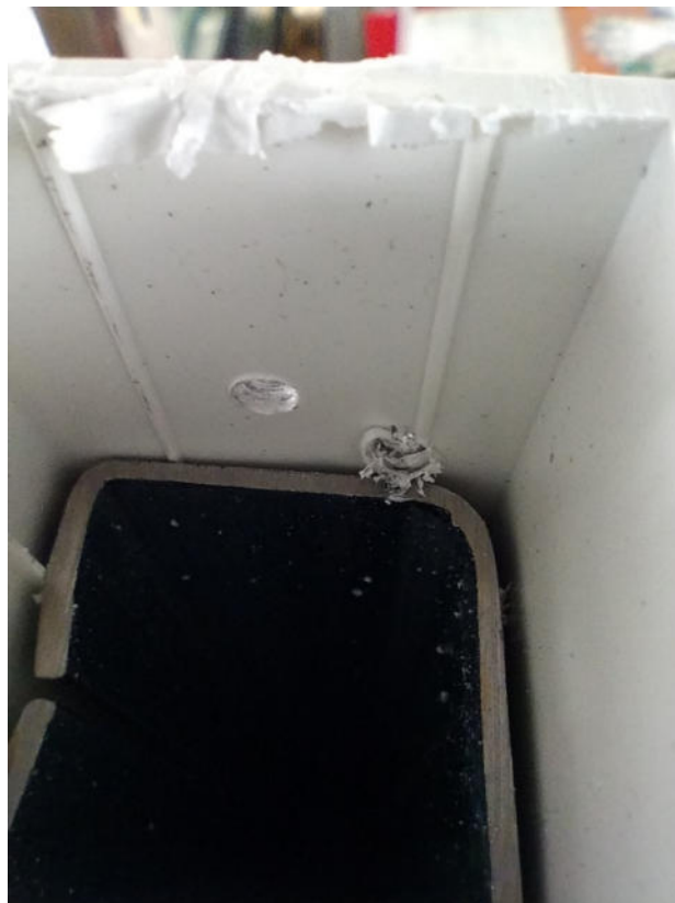
Рисунок 3.9 – Нарушение условий крепления узлового элемента импоста в образце SL70-18
